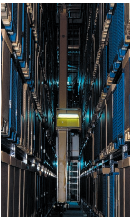
Auch das vollautomatische Hochregallager wird über die neue ERP-Software gesteuert.
